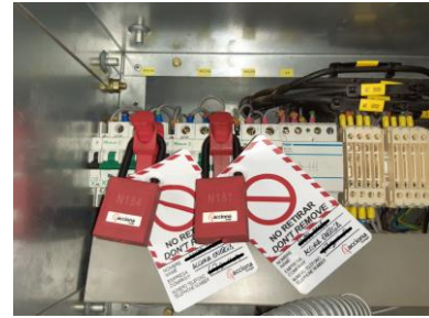
Sistema LOTO instalado
