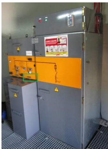
Celda Ibérica en condiciones de servicio nominal. Sobre la foto, ubicación del selector a consignar.
