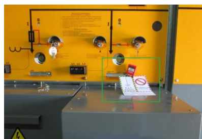
Enclavamiento del selector en posición MANIOBRA. Cuando el candado está instalado no se puede introducir el timón en la mirilla.
